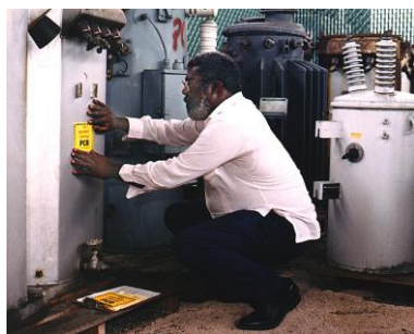
Foto 4 Rotulación de equipo conteniendo PCB
