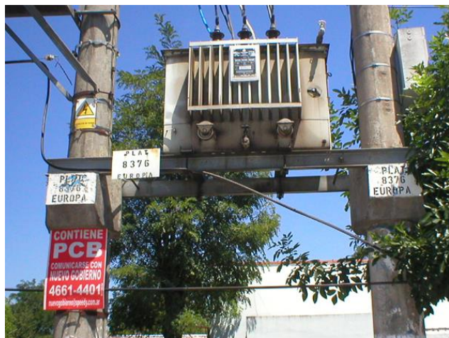
Foto 1 Transformador conteniendo PCB (corresponde a un sistema completamente cerrado)
