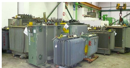
Foto 3 Transformadores en los cuales se ha identificado la presencia de PCB
