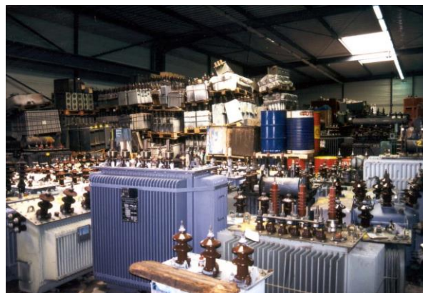
Foto 1 Almacenamiento de equipos eléctricos obsoletos conteniendo PCB (Fuente: PNUMA, 2002)
